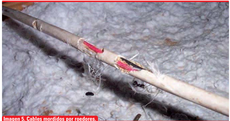
Imagen 5. Cables mordidos por roedores.
